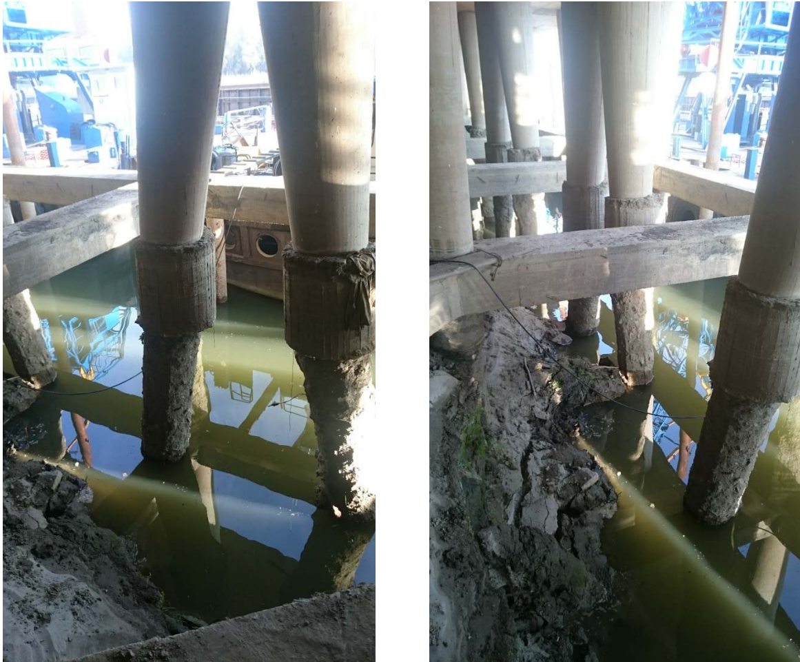
Slika 2.3: Karakterističan izgled oštećenja pilota stupova
